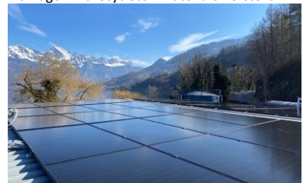
Solaranlage auf dem sagibeiz - Dach
